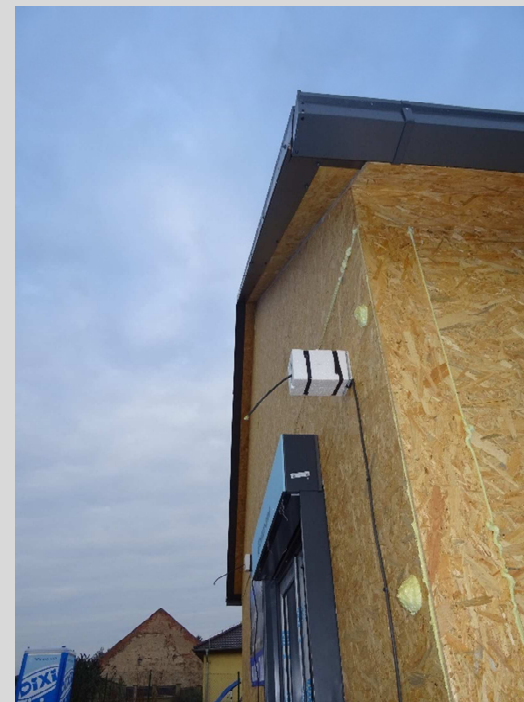
Venkovní prostup elektroinstalace
